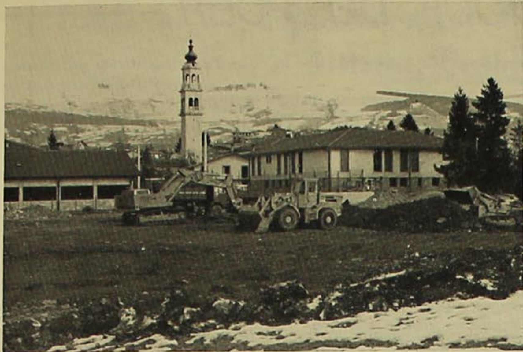
Gennaio 1982 - Le pale meccaniche ed i camions dell'impresa Gelmini lavorano alla costruzione del nuovo campo sportivo.
